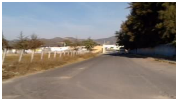
Fig. 47. Vista de vialidad en buena condición. Foto por Camerino Pérez Aguilar.
