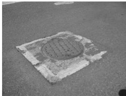
Foto 7._ Infraestructura Hidraulica. (Redes De Desagüe) Un servicio que nos ayudara a desacernos y canalizar aguas amoniacales (desechos sanitarios) aguas servidas (resultantes de higiene personal, vivienda o grasas) y aguas pluviales. Imagen tomada por D.O.L
