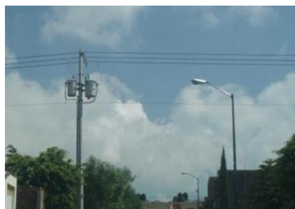
Foto 4. Infraestructura Energetica. (Redes De Electricidad) Villas de La Loma Cuenta redes de baja tension (domiciliaria) y alta tension. (transporte de energia a grandes distancias). Imagen tomada por D.O.L
