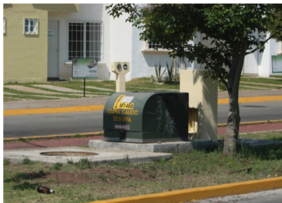
Imágen 17: Sub-estación eléctrica, CFE. Foto tomada por los autores, 12 de Mayo del 2012
