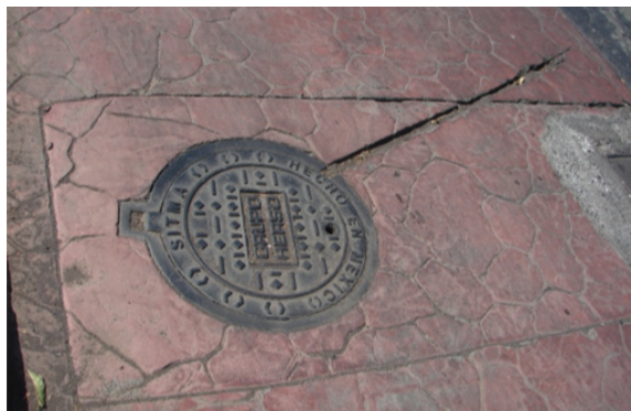
Imágen 15: Registro de aguas servidas. Foto tomada por los autores, 12 de Mayo del 2012
