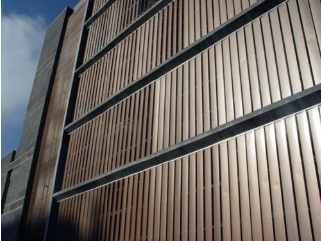
Foto 34: lamina en el exterior
