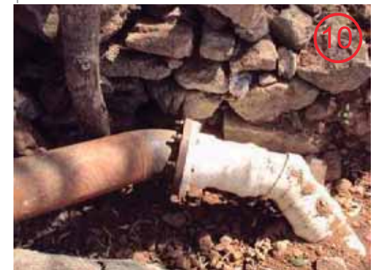
Figura 40. Infraestructura para servicio de agua potable. Foto: Autores de tesis
