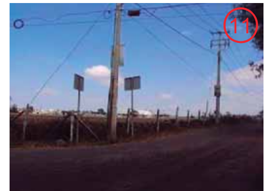
Figura 41. Red eléctrica de media y baja tensión Foto: Autores de tesis
