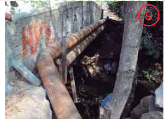
Figura 39. Infraestructura para servicio de agua potable. Foto: Autores de tesis
