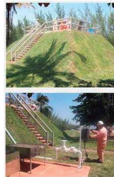
Figura 94. PLANTA DE TRATAMIENTO DE AGUAS RESIDUALES. Fuente: http://www.cbringenieria.com.mx/compacta.html . [15-mayo-2012]
