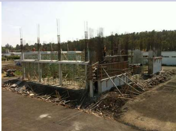
Fig. 2.3.2.1 Contexto Físico de la obra, Centro de Innovación Tecnológica para la Industria de la Construcción.
