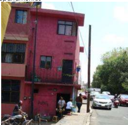
Figura 45. Tipología de vivienda en el tramo 2 ámbito centro, viviendas viejas deterioradas de dos niveles.
