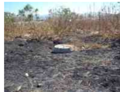
52 POZO DE REGISTRO A.H.M.
