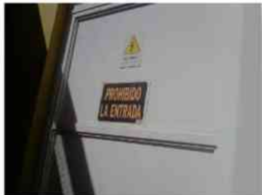
Fig. 1.2.2.14. Cuarto de maquinas
