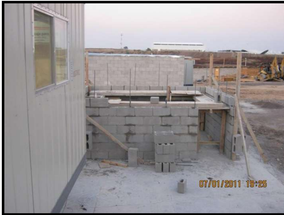
Figura 045. Instalación de Oficinas de Campo para Personal Técnico. Fuente: Consultores de la Obra Publica S. C. [2011]
