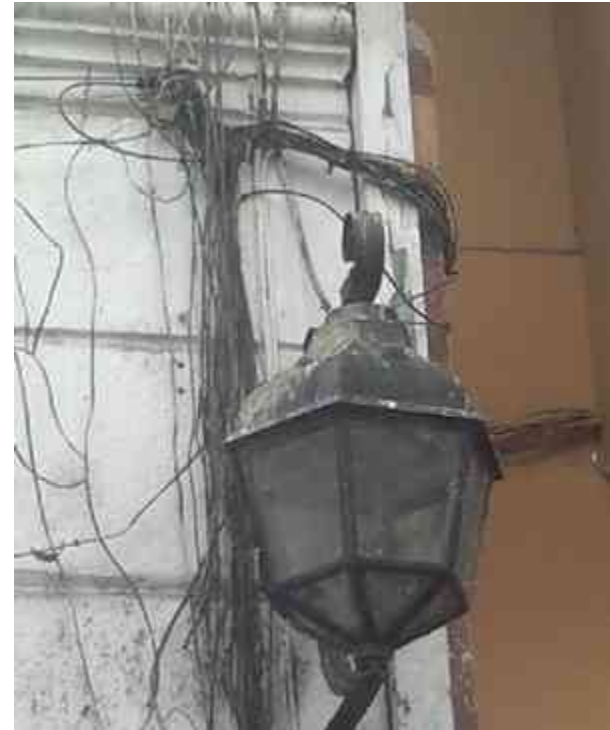
Imagen: N°81 Cableado a la intemperie en Fachadas Tomada por (Ma. De Lourdes Sánchez Aguirre)
