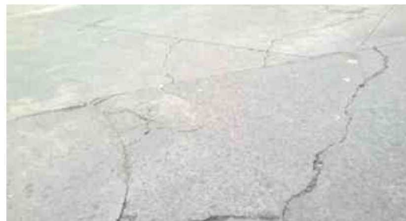
Imagen: N° 65 Pavimento en mal estado Tomada por (Ma. De Lourdes Sánchez Aguirre). Mayo 2013.
