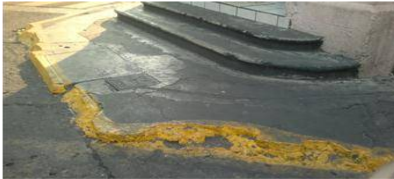
Imagen N° 122 Banqueta calle Ocampo, fotografía tomada por (Ma. De Lourdes Sánchez Aguirre), Mayo 2013.
