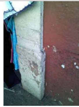
AD-012. Suciedad en elementos de cantería.
