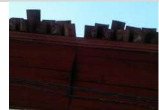
AD-016. Trastejado en mal estado.
