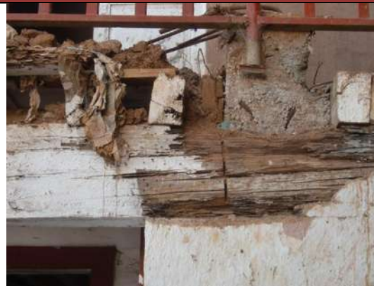
Imagen 98. Viguería de entrepiso dañada en riesgo de colapso. Foto. Iriele Suárez González.
