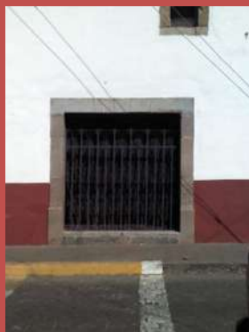
AD-O4. Alteraciones en vanos en puertas y ventanas.
