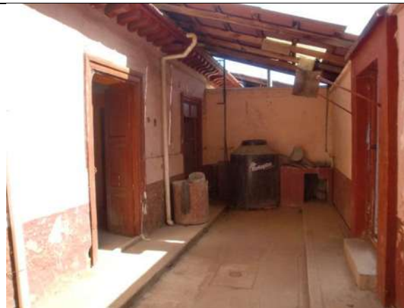
Imagen 101. Área de servicio, falta de mantenimiento. Foto. Iriele Suárez González.
