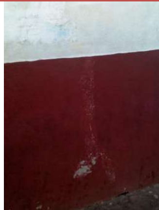
AD-06. Deterioro de pintura en fachada.
