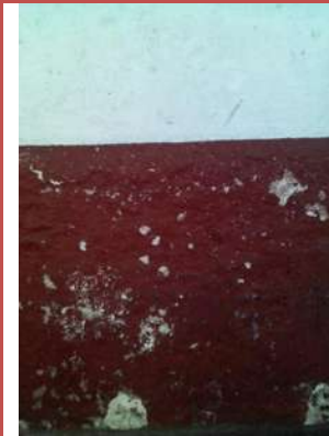
AD-06. Deterioro de pintura en fachada.
