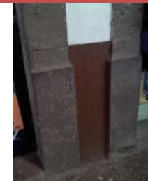
AD-012. Suciedad en elementos de cantería.
