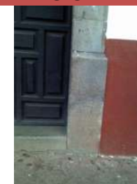
AD-012. Suciedad en elementos de cantería.
