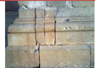
AD-010. Disgregación del material de junteo en elementos de cantería.
