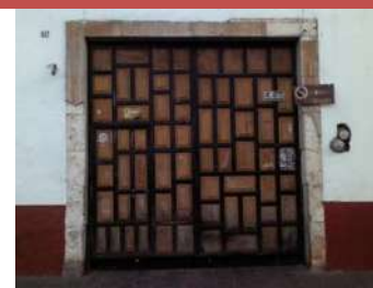
AD-011. Deterioro en elementos de cantería.
