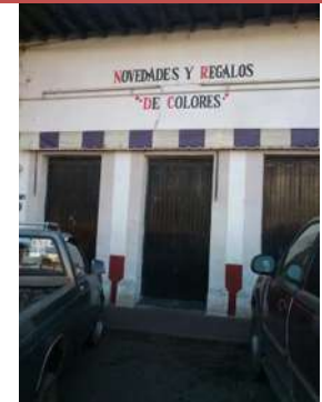
AD-04. Alteraciones en vanos en puertas y ventanas.
