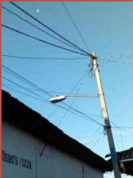
AD-03. Contaminación visual por postes y cableado aéreo.
