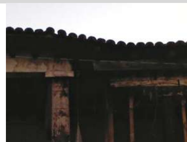
AD-016. Trastejado en mal estado
