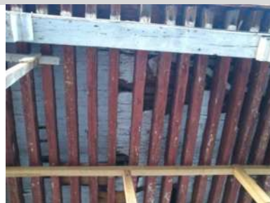
AD-015. Elementos de madera deteriorados.
