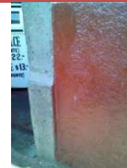
AD-012. Suciedad en elementos de cantería.
