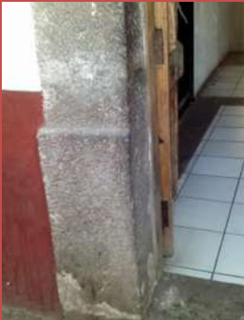
AD-012. Suciedad en elementos de cantería.
