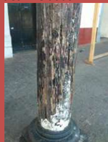
AD-014. Columnas deterioradas.
