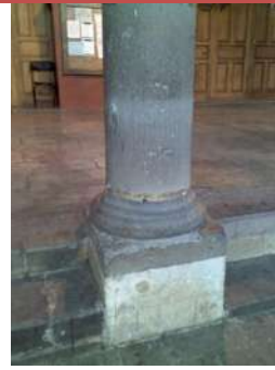
AD-012. Suciedad en elementos de cantería.
