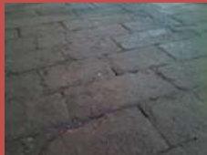
AD-01. Baldosas de piedra dañadas y desniveladas.
