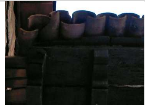
AD-016. Trastejado en mal estado.
