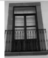
AD-012. Suciedad en elementos de cantería.
