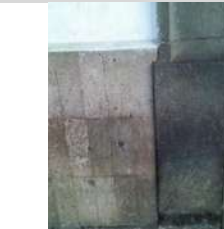
AD-012. Suciedad en elementos de cantería.
