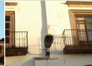
AD-018. Luminarias en mal estado.
