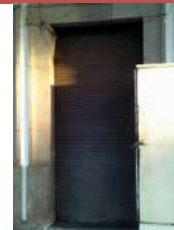
AD-09. Materiales y diseños discordantes en puertas y ventanas.
