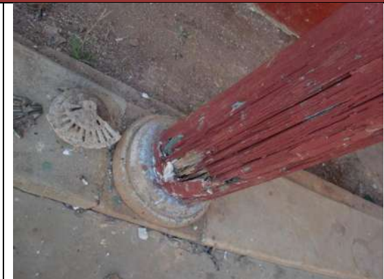
Imagen 99. Columna de corredor, con problemas estructurales por daños en madera y base de cantería. Foto. Iriele Suárez González.
