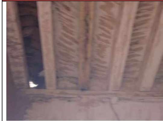
Imagen 97. Viguería y tapa de entrepiso, deteriorada por humedad, polilla y falta de mantenimiento. Foto. Iriele Suárez González.
