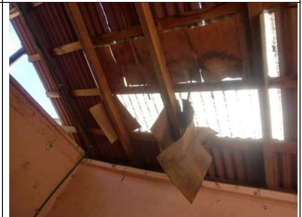
Imagen 102. Techumbre de área de servicio, falta de mantenimiento. Foto. Iriele Suárez González.
