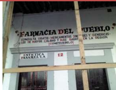
AD-07. Saturación de publicidad en fachadas.
