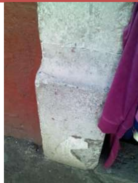
AD-011. Deterioro en elementos de cantería.
