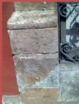
AD-012. Suciedad en elementos de cantería
