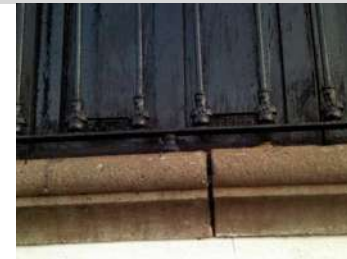
AD-010. Disgregación del material de junteo en elementos de cantería.
