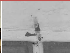
AD-06. Deterioro de pintura en fachada.
