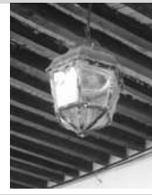
AD-018. Luminaria en mal estado.
