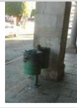
AD-020. Mobiliario urbano en mal estado.
