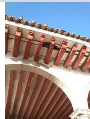
AD-015. Elementos de madera deteriorados.
