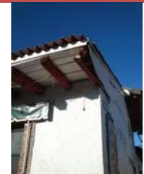
AD-015. Elementos de madera deteriorados.
