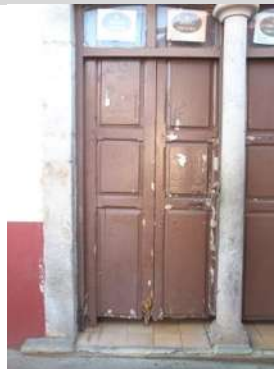
AD-015. Elementos de madera deteriorados.
