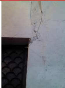
AD-06. Deterioro de pintura en fachada.
