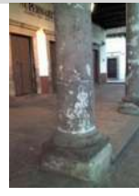
A2-012. Suciedad en elementos de cantería.
