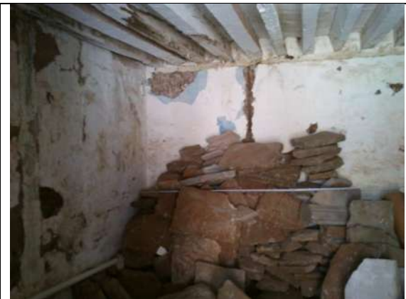
Imagen 96. Habitación con daños en todos sus elementos. Foto. Iriele Suárez González.
