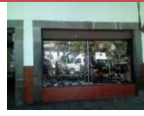
AD-04. Alteraciones en vanos en puertas y ventanas.
