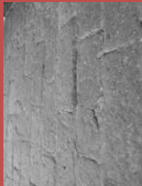
AD-01. Baldosas de piedra dañadas y desniveladas.
