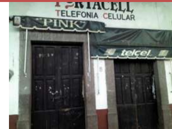
AD-08. Contaminación visual por toldos en fachadas.
