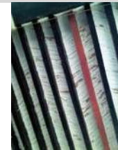
AD-015. Elementos de madera deteriorados
