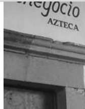
AD-011. Deterioro en elementos de cantería.
