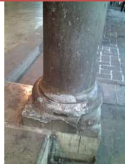
AD-011. Deterioro en elementos de cantería.
