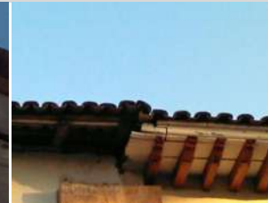
AD-016. Trastejado en mal estado.
