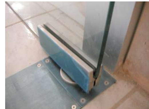
IMAGEN 186 Bisagra hidráulica terminada en puertas de cristal templado. P.B, 1°, 2°, 3er nivel
