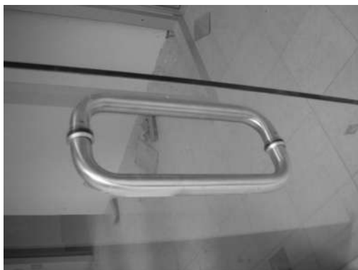
IMAGEN 184 Jaladeras de acero inoxidable en puertas de cristal templado. P.B, 1°, 2°, 3er nivel
