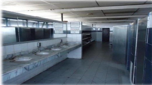
Vista de los baños en malas condiciones
