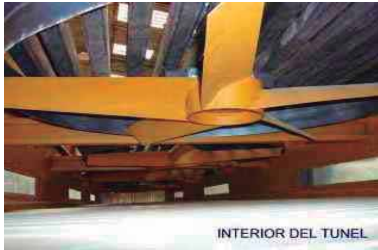
Imagen 12 – “INTERIOR DEL TUNEL DE SECADO” - RAMOS TALLERES & MAQUINARÍA, 12530 Burriana (Castellón), España
