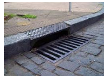
Imagen 36. Registro de drenaje.
