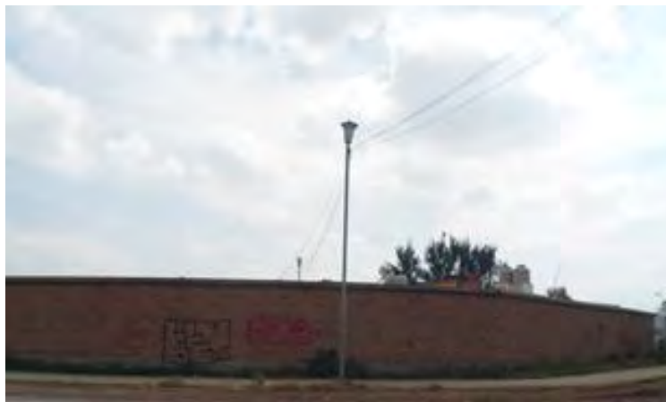
Imagen 46. Equipamiento Urbano. Alumbrado público en el fraccionamiento Altamira Residencial. Fotografía tomada por: Arianna C. Navarrete A. el 20 de octubre de 2012.
