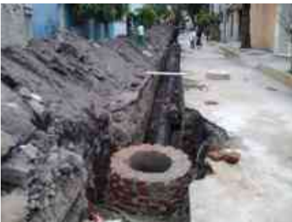
Imagen 78.- Pozo de visita y tubería.
