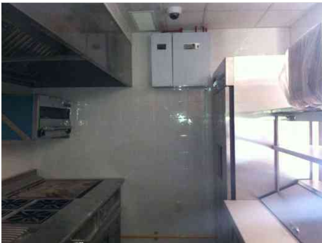
Imagen 116 Instalación de sistema anzul de seguridad para tren de cocción.
