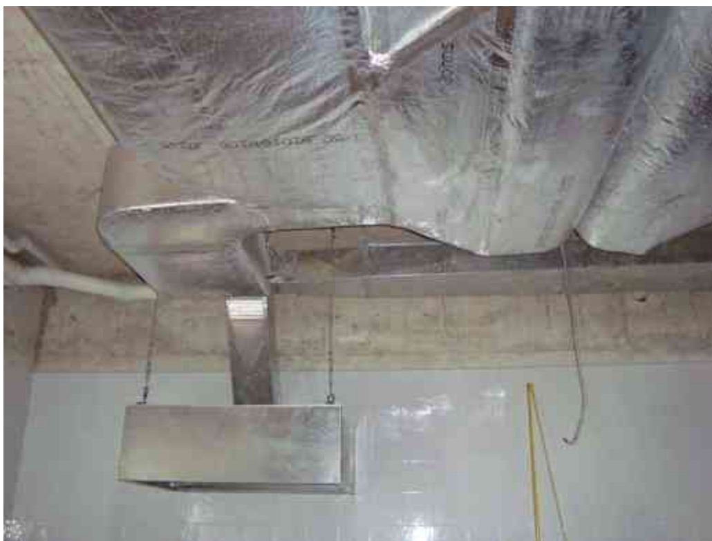
Imagen 102 Ductos en Área de Cocina, para extracción de aire.
