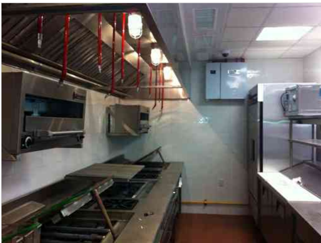
Imagen 117 Sistema anzul completo, como sistema de emergencia en caso de incendio.
