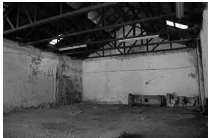
Imagen 64. Interior de la nave central de la Fábrica. Donde se puede observar las antiguas bodegas en deterioro.
