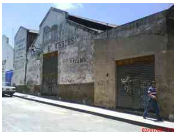
Imagen 57. Fachada con orientación este. Donde se puede apreciar el deterioro de la fachada por la humedad, la incidencia del Sol y las características de los materiales utilizados en la zona
