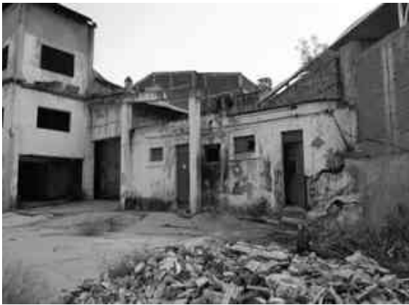
Imagen 63. Interior del Patio Central de la Fábrica. Donde se puede observar las antiguas bodegas en deterioro.
