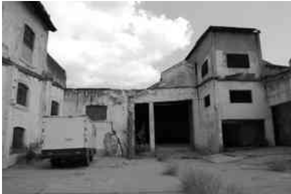
Imagen 62. Interior del Patio Central de la Fábrica. Donde se puede observar las antiguas bodegas en deterioro.
