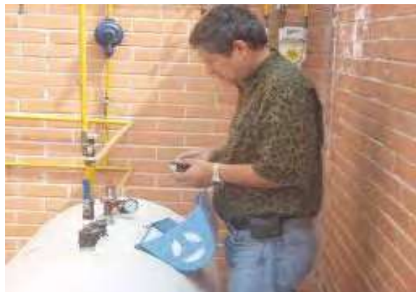
Fig. 117 Muestra la colocación de la instalación de tanque estacionario de gas / Fuente: https://www.google.com.mx/search?q=imagenes+d
