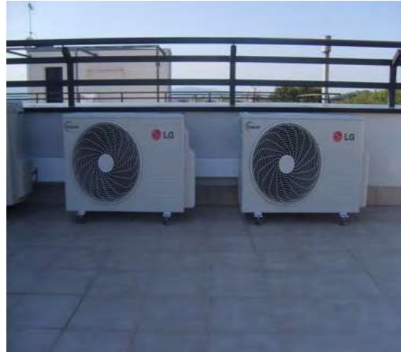
Fig. 119 Muestra la colocación los aires acondicionados / Fuente: https://www.google.com.mx/search?q=imagenes+d
