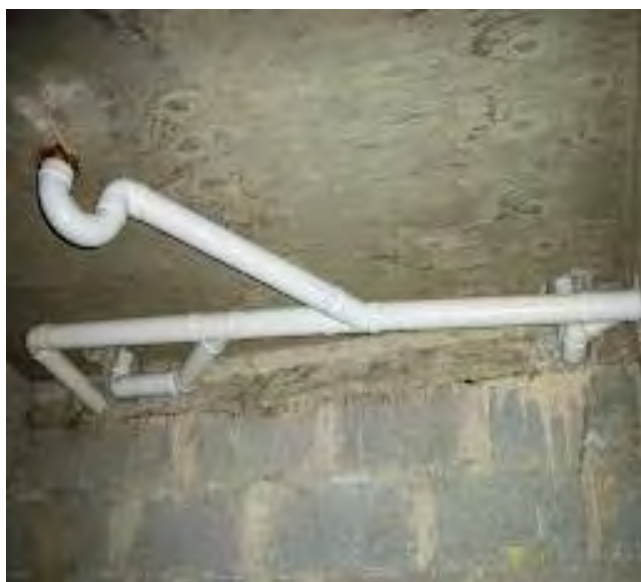
Fig. 110 Muestra la instalación sanitaria con tubos de P.V.C. / Fuente: Foto tomada por OME
