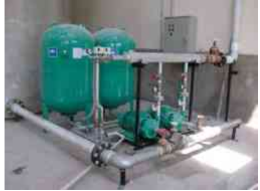
F61. Instalación Hidráulica
