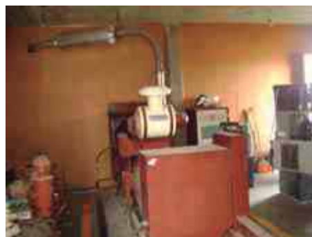
Img. 65.- Planta eléctrica de emergencia. Por JSB.
