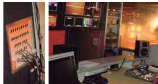
Img. 48.- Cada set de televisión cuenta con una cabina de control de audio, video e iluminación, toda la instalación es conectada a un panel de conexión controlada en cabina. Por JSB.
