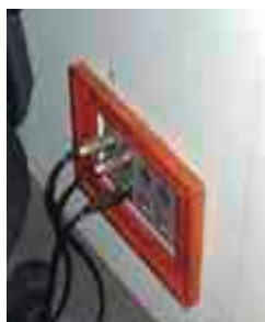
Img. 53.- Panel de conexión a cabina de transmisión. Por JSB.
