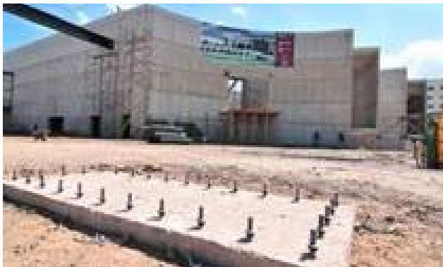
IMAGEN No. 48 , construcción del museo interactivo de ciencia y tecnología nayarit , imagen disponible en http://www.nnc.mx/imagenes/1313162295.jpg , actualizada el 23 de marzo 2014
