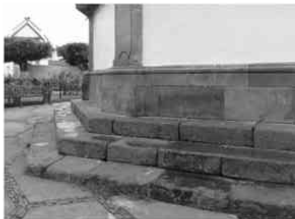
Fig. 97 Canteras fracturadas y enlamadas
