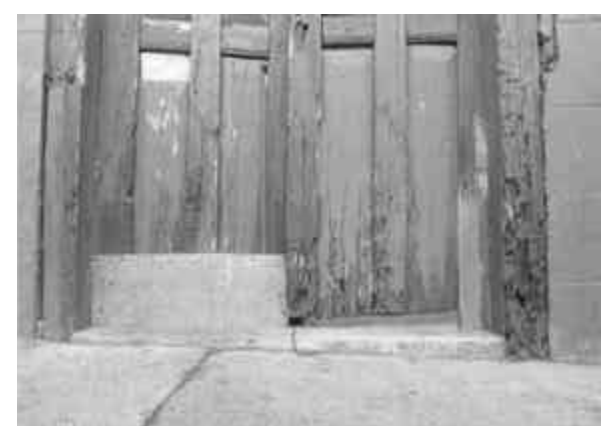
Fig. 95 Puerta deteriorada de la avenida
