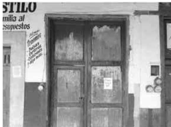
Fig. 94 Puerta deteriorada Portal Morelos
