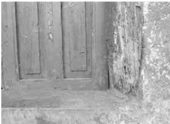
Fig. 93 Puerta deteriorada de la avenida
