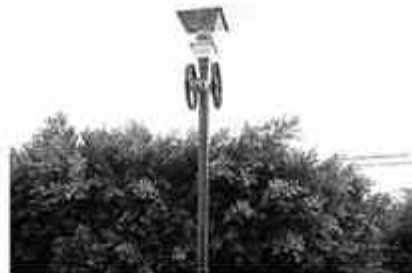
Postes de iluminación
