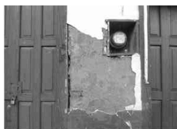
Fig. 101 Deterioro en aplanados
